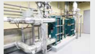
病院から市へ排熱熱エネルギーを融通する蓄熱用熱交換器
