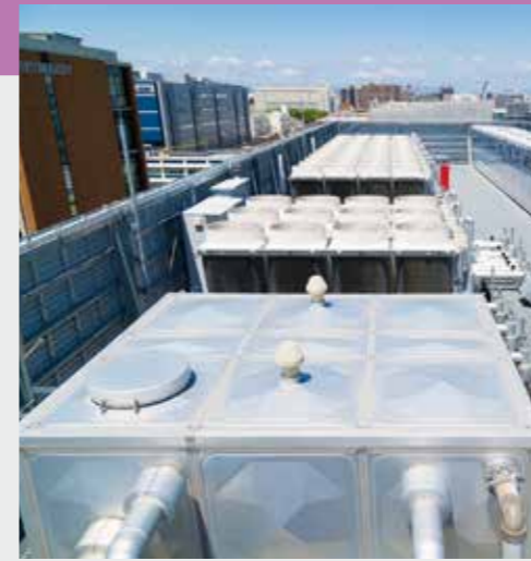
氷蓄熱槽(手前)
