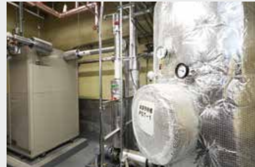
下水熱回収型ヒートポンプチャラー(左)と予熱槽
