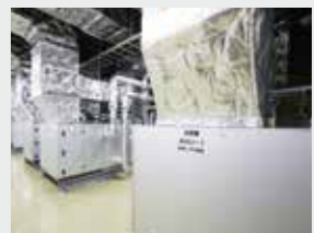
空気の温度・湿度を調節して部屋へ供給するエアハンドリングユニット
