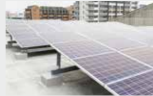
太陽光発電パネル(20.8kW)
