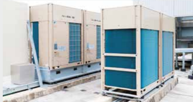
屋上に設置されたビル用マルチエアコンの室外機
