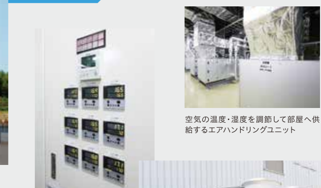
機械室の制御盤に設置されたチラーのリモコンで水温を操作する
