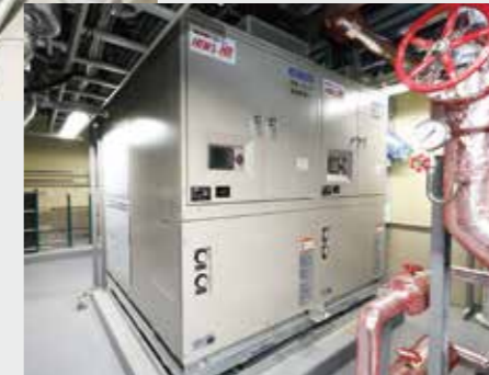
病院内に設置されている排熱回収型インバーターチャラー
