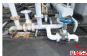
工場の排湯取込箇所
