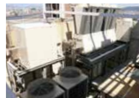
空冷HPと蓄熱槽
