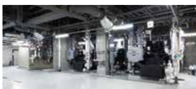
インバーターボ冷凍機
