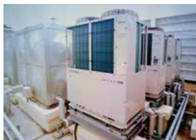
業務用エコキュート室外機
