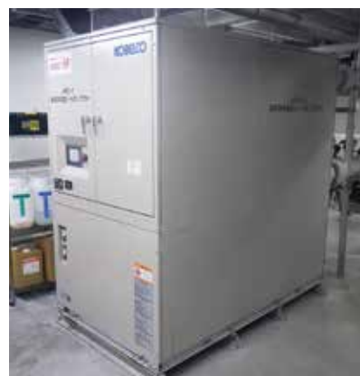
排熱回収ヒートポンプ
