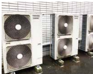
循環加温ヒートポンプの室外機
