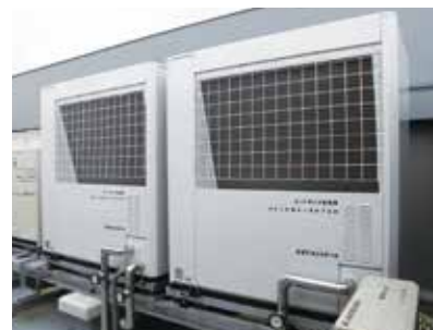
業務用エコキュート室外機
