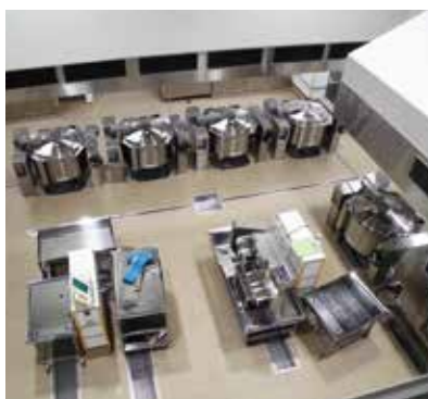
電化厨房機器を採用した調理室
