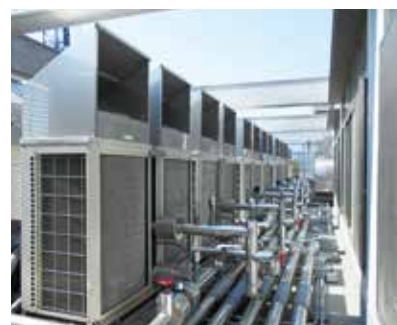
ヒートポンプチラー
