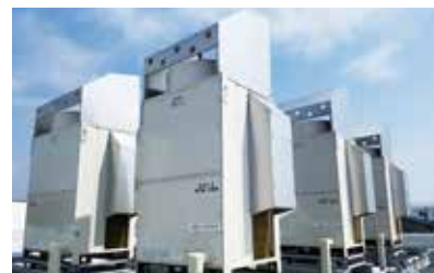
ビル用マルチエアコン室外機
