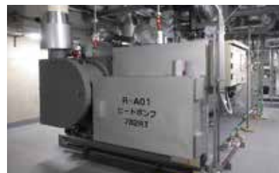
西プラント ターボヒートポンプ
