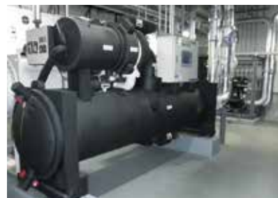
ターボ冷凍機
