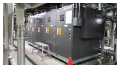
冷温同時ヒートポンプ
