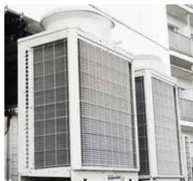
業務用エコキュート室外機
