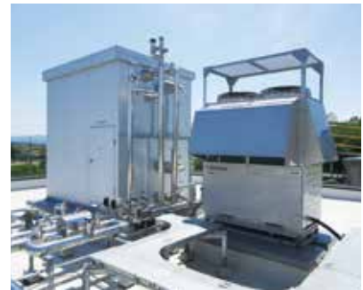
業務用エコキュートと貯湯槽
