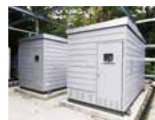
ガス焚吸収式冷温水機
