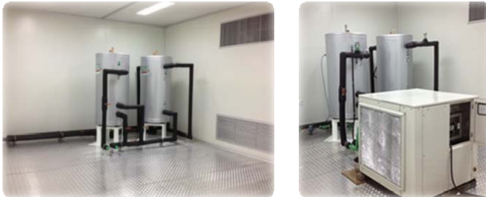
図 5 : KMUTT のヒートポンプ用試験室
