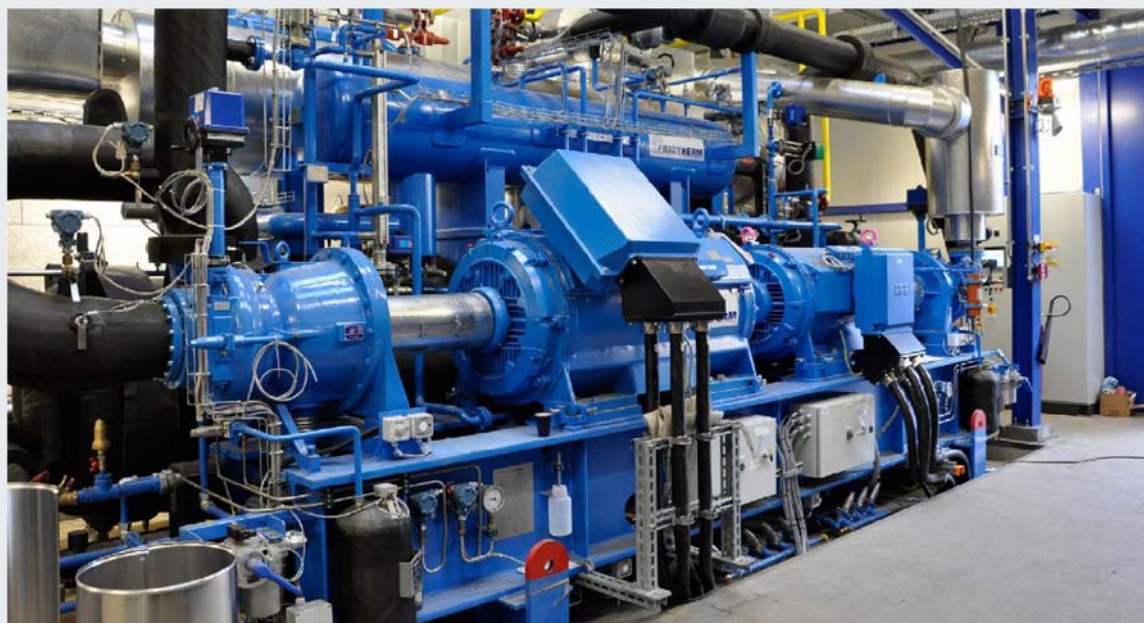
図2：“Marienhütte”にあるヒートポンプ [1]
