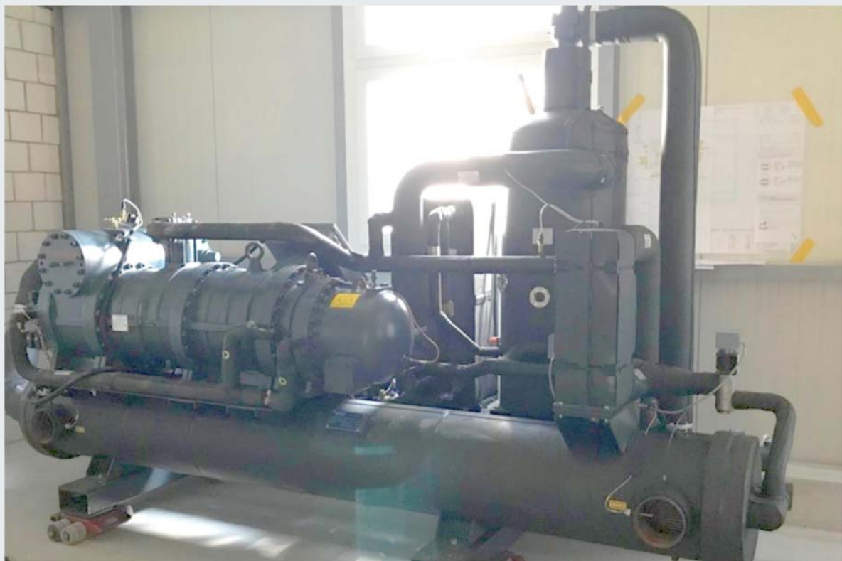
図 2: マウンテンチーズ工場の技術室に設置された高温ヒートポンプ [4]。 微燃性冷媒 R1234ze (E) は、防火および脱出ルートのための特別な手段を要求します。
