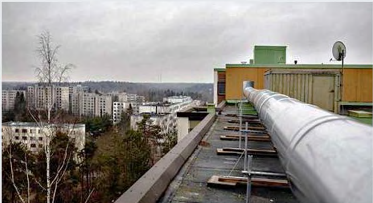
Fig. 2: 地熱改修に関連して、エスポーのアパート建設会社の機械的排気換気に熱回収システムが追加されました。システム内のパイプは家の屋根の上を走っています。写真: K. Rautaheimo, Helsingin Sanomat.
