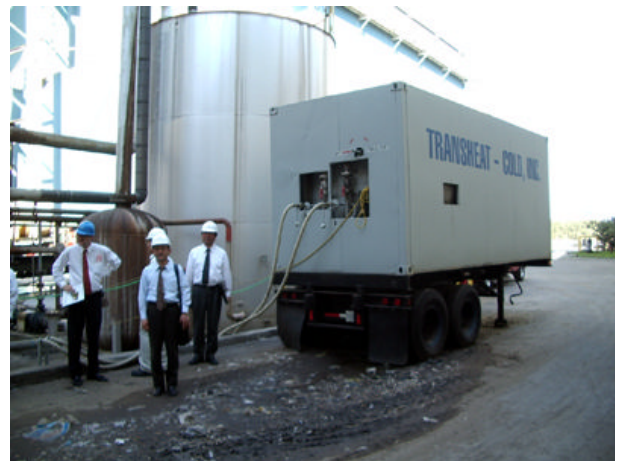
写真 5 排熱源からの蓄熱の状況
